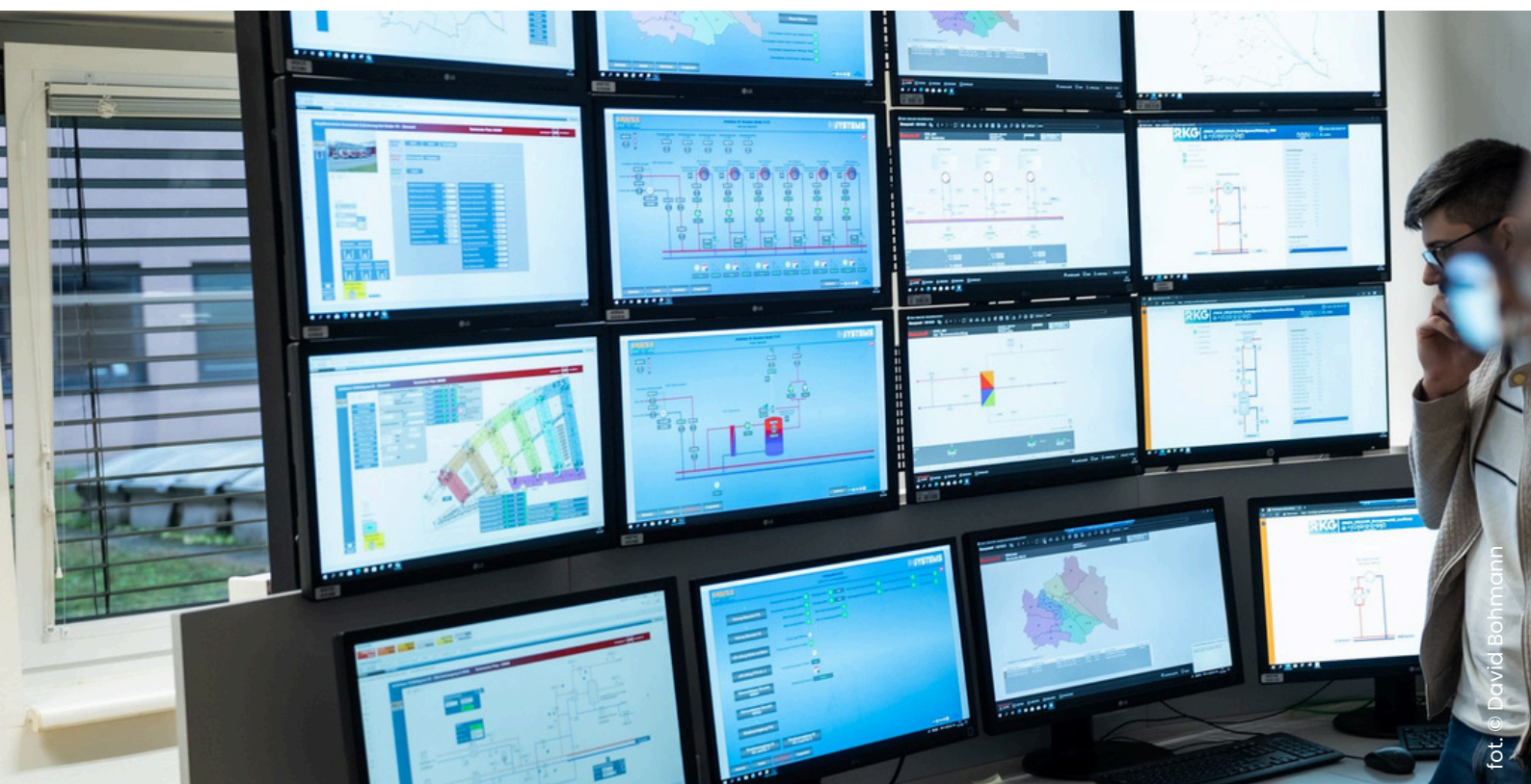
Dyspozytornia systemu zarządzania budynkami MA 34.
